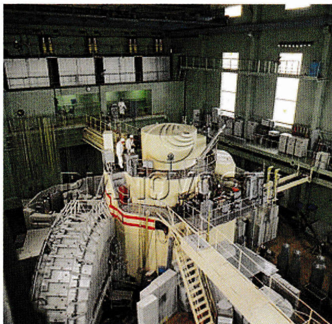
Центральный зал реакторной установки ВВР-М
