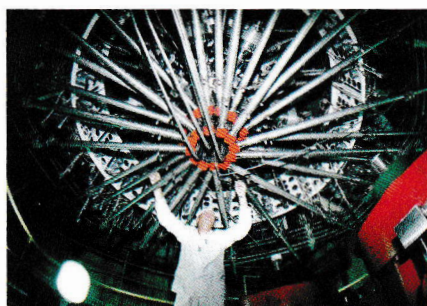
Узлы отвода воды из ВОТК
