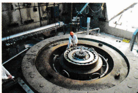
Верхняя часть реактора ИВГ.1М
